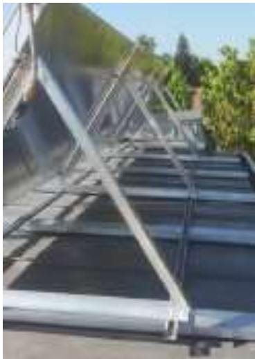
Abbildung 5: Solaranlage, auf nachträglich ausgebildeten Leistenfalzen montiert.
