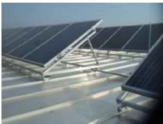
Abbildung 1: Aufgeständerte Anlage auf eine Doppelstehfalzeindeckung mit Falzklemmen befestigt
